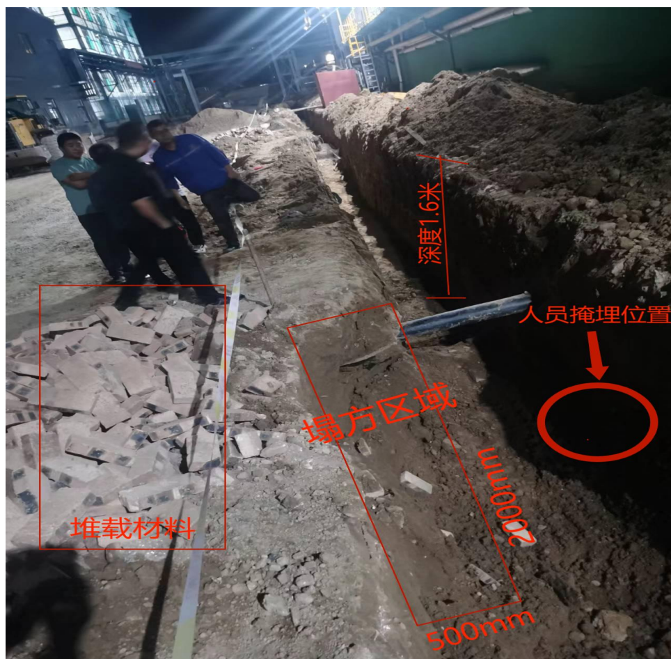
图-2 坍塌管沟现场勘验照片
